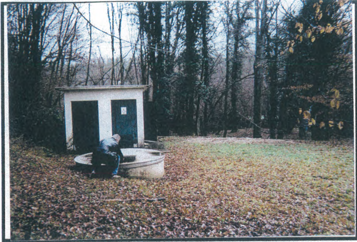
PHOTO P3 : Tête de puits et bâtiment technique
